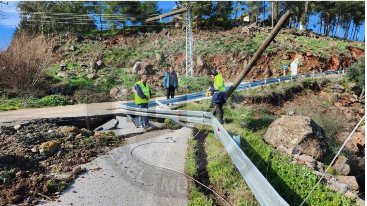
Kırıkhan-Hassa arasında, yüzey kırığı boyunca köy yolunda ve oto korkulukta izlenen sol yanal yer deęiřtirme
