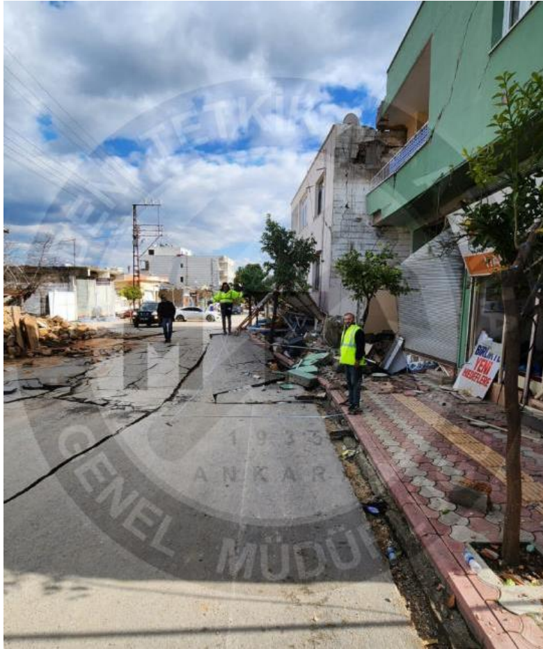
Hassa merkezinde izlenen sol yanal yer deęiřtirme
