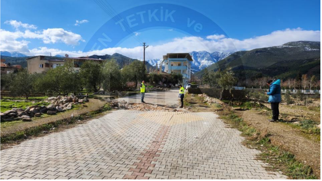
Hassa merkezinde izlenen 310 cm sol yanal yer deęiřtirme
