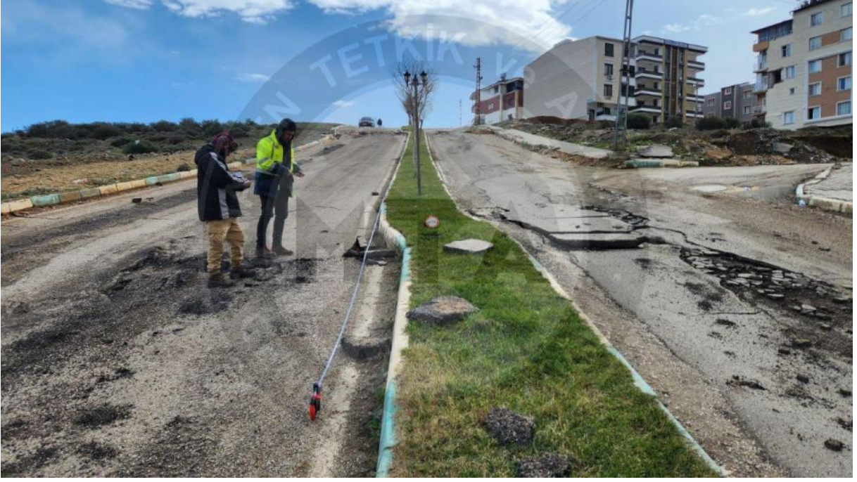
Kırıkhan ilçe merkezinde sol yanal ötelenmiş yol
