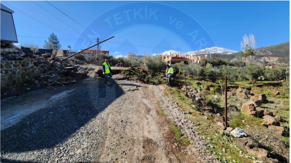
İslahiye yakın güneyinde, bahçe duvarı ve yolda izlenen sol yanıl yer değıştirme
