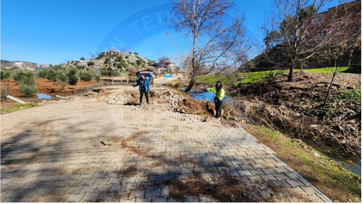
İslahiye güneyinde, yol ve su kanalında gözlenen sol yanal ötelenme
