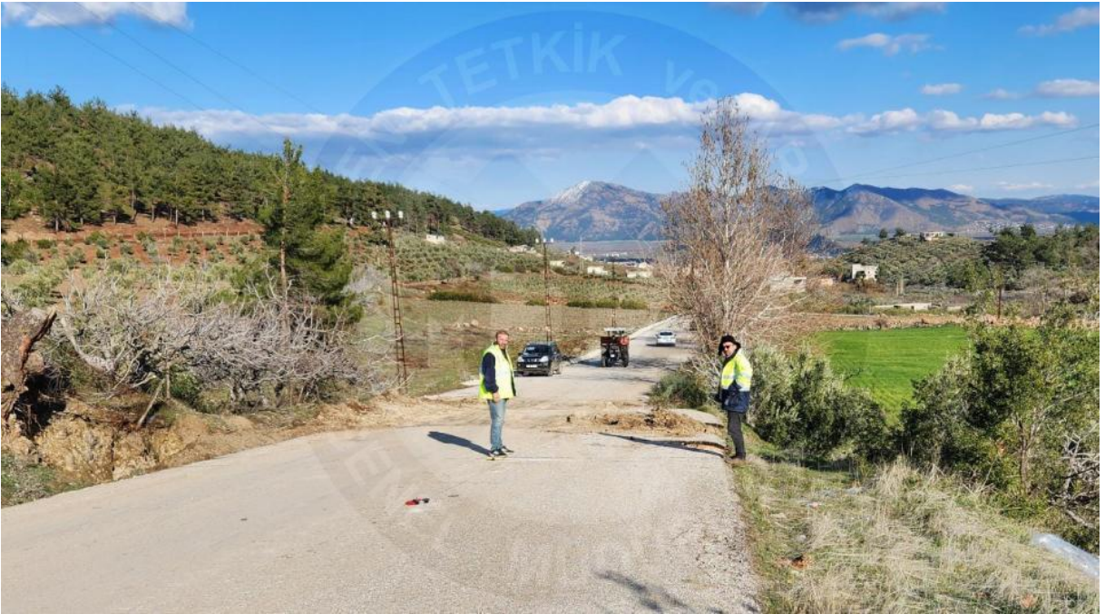
Hassa kuzeyi, asfalt yolda sol yanal telenme
