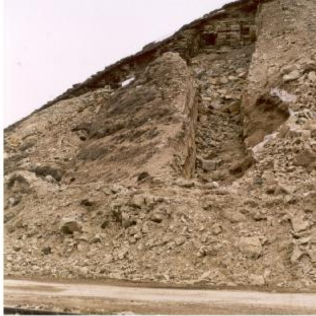
Foto 12: Alaca Köyü - Kandilli Yolu üzerinde meydana gelmiş düzlemsel kayma. Bakış güneyedir.
