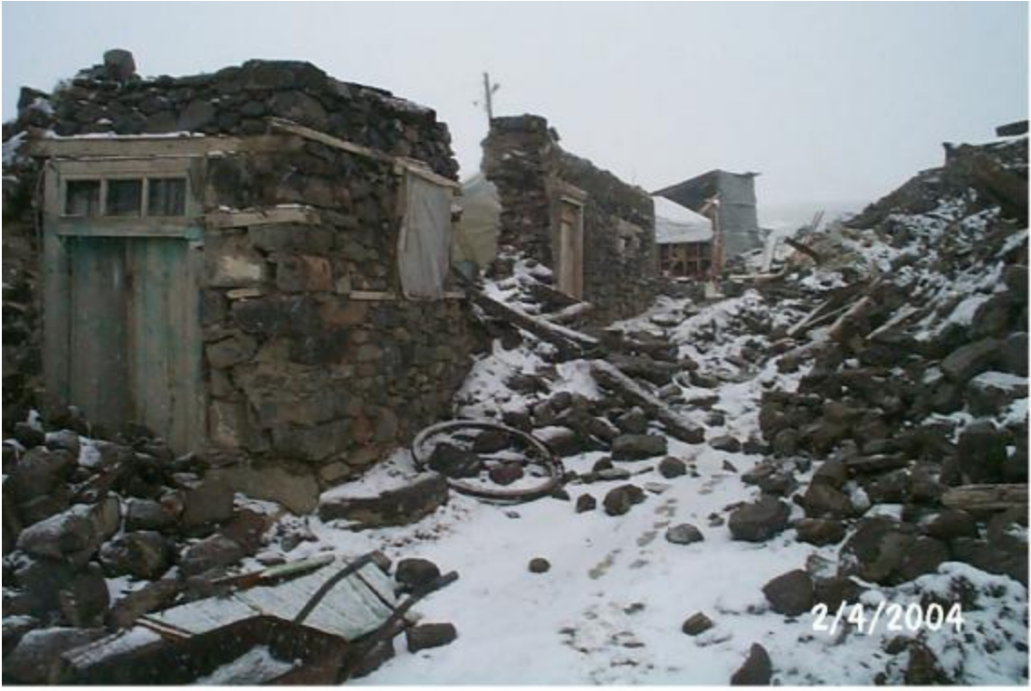
Foto 21: Atlikonak Köyünde geleneksel yığma yapılarda depremde meydana gelen hasar.
