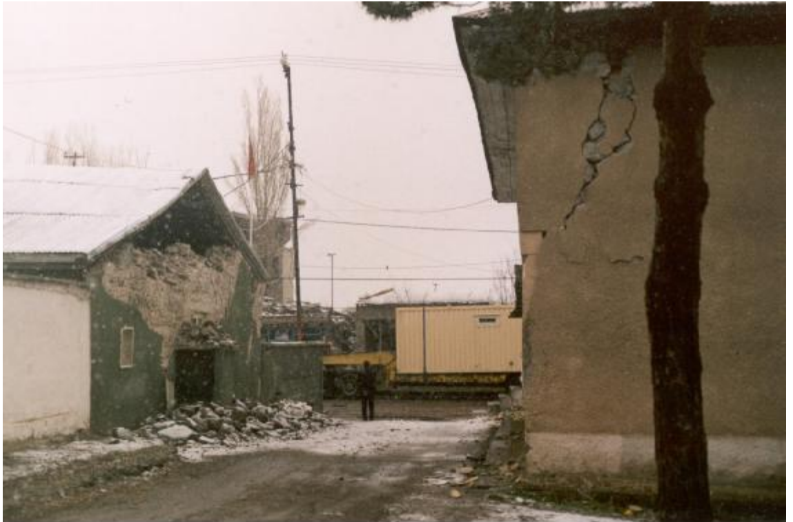
Foto 32: Kandilli ilçesi Jandarma Karakol binasında meydana gelen hasar ve çatlaklar.
