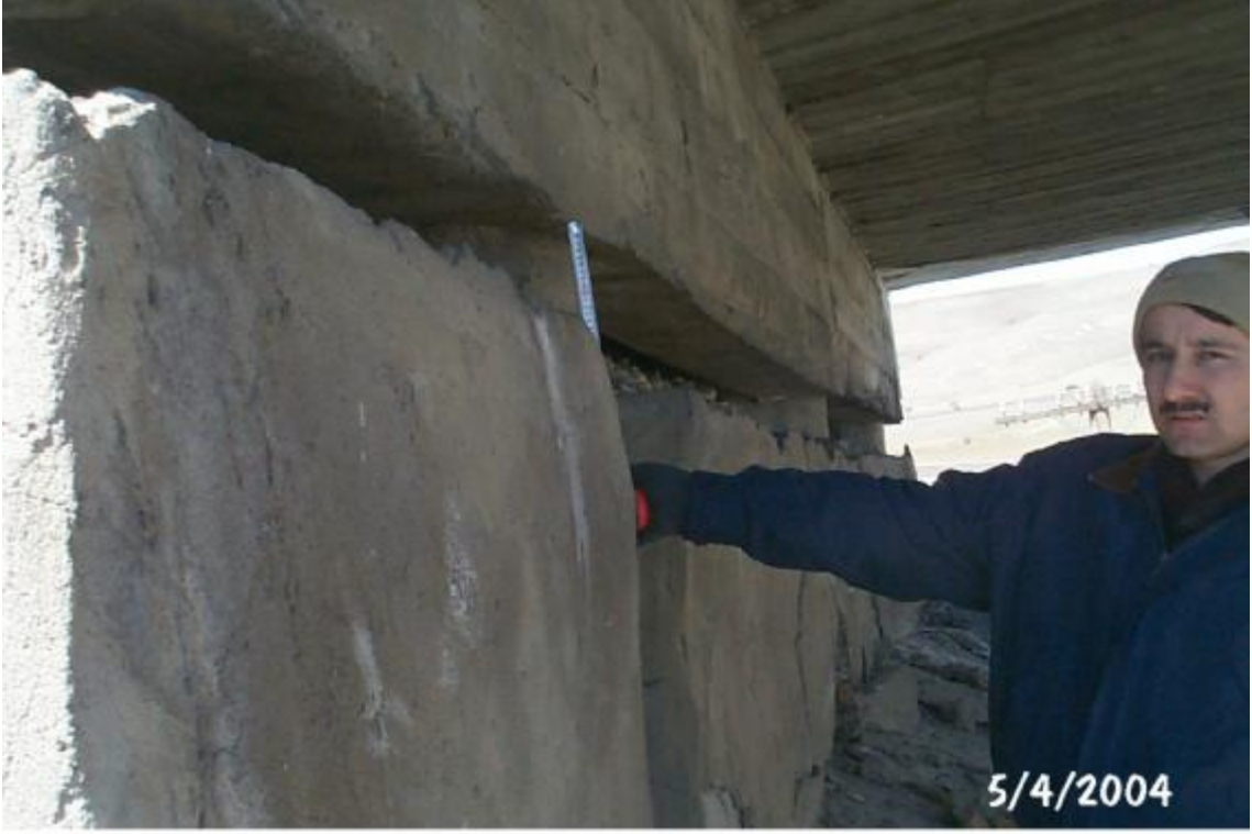
Foto 18: Aşkale-Erzurum karayolu köprüsünde depremle meydana gelen yükselme. Bakış batıyadır.
