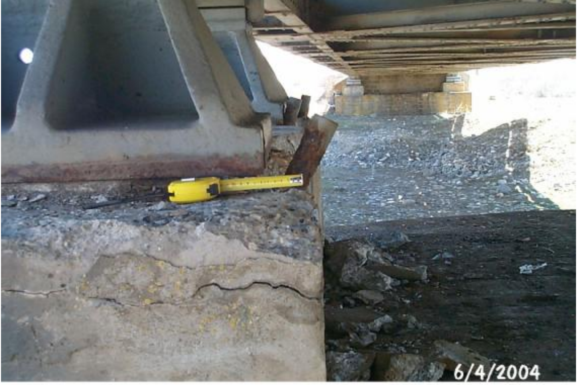
Foto 15: Küçükgeçit Köyü doğusundaki demiryolu köprüsünün orta ayağında depremle meydana gelmiş deformasyon. Bakış doğuyadır.
