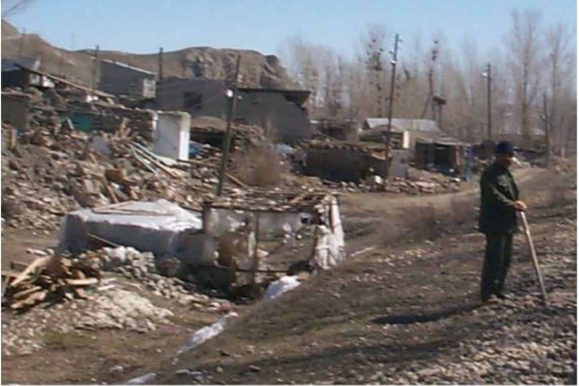
Foto 26: Küçükgeçit Köyünde geleneksel yığma yapılarda depremde meydana gelen hasar.
