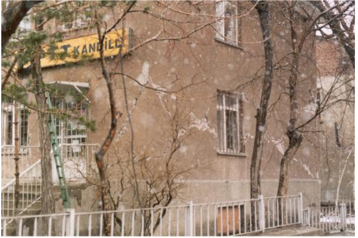
Foto 29: Kandilli ilçesi PTT binasında meydana gelen hasar ve çatlaklar.
