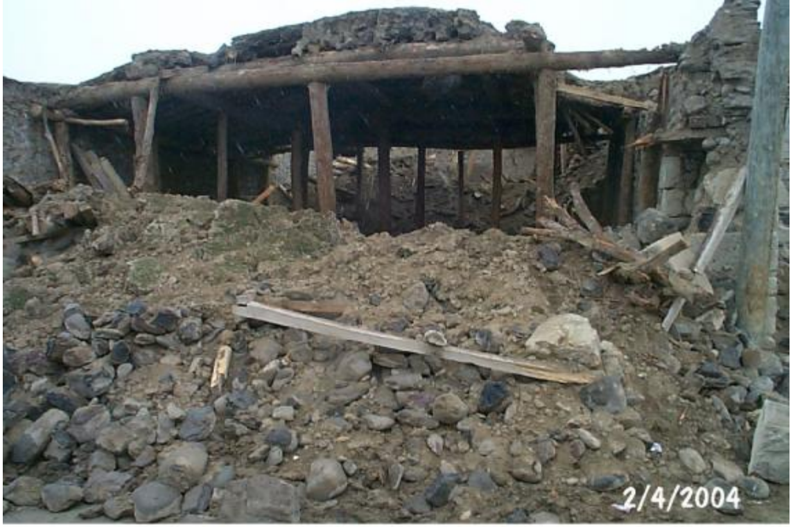
Foto 19: Alaca Köyünde geleneksel yığma yapılarda depremde meydana gelen hasar.
