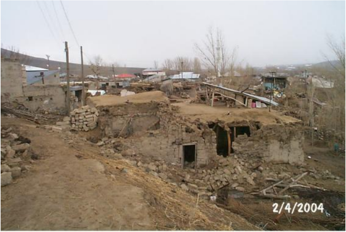
Foto 25: Alaca Köyünde geleneksel yığma yapılarda depremde meydana gelen hasar.
