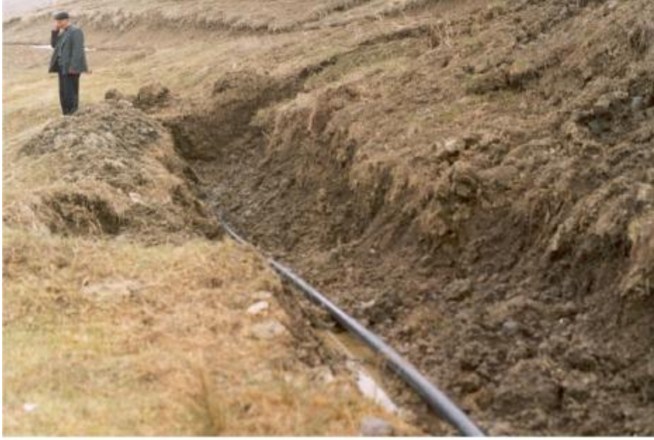
Foto 8: Alaca Köyü içme suyu şebekesinde sığ kaymalardan dolayı gelişen hasar. Bakış güneyedir.
