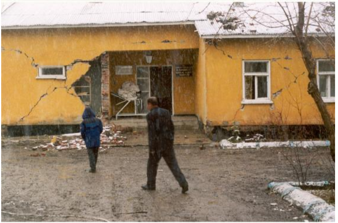
Foto 31: Kandilli ilçesi Sağlık Ocağı binasında meydana gelen hasar ve çatlaklar.:
