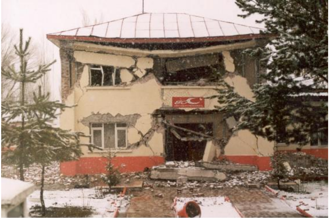
Foto 30: Kandilli ilçesi Askeri Gazinonun binasında meydana gelen hasar ve çatlaklar.
