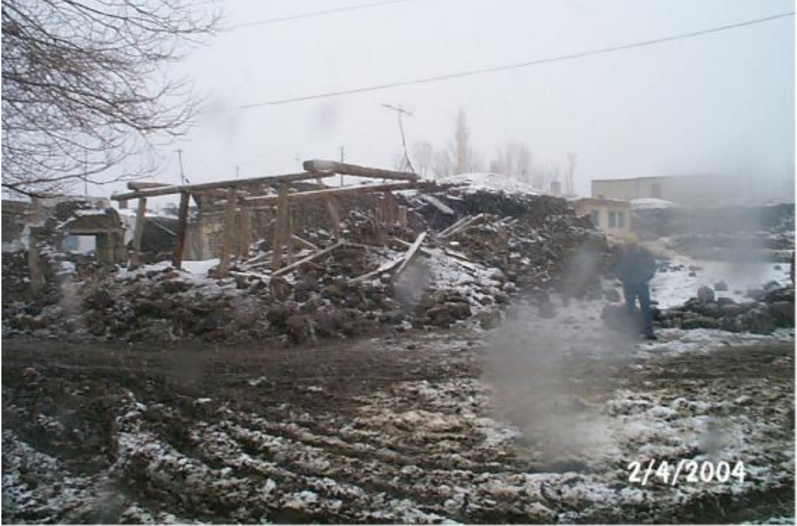
Foto 22: Ortabahçe Köyünde geleneksel yığma yapılarda depremde meydana gelen hasar.
