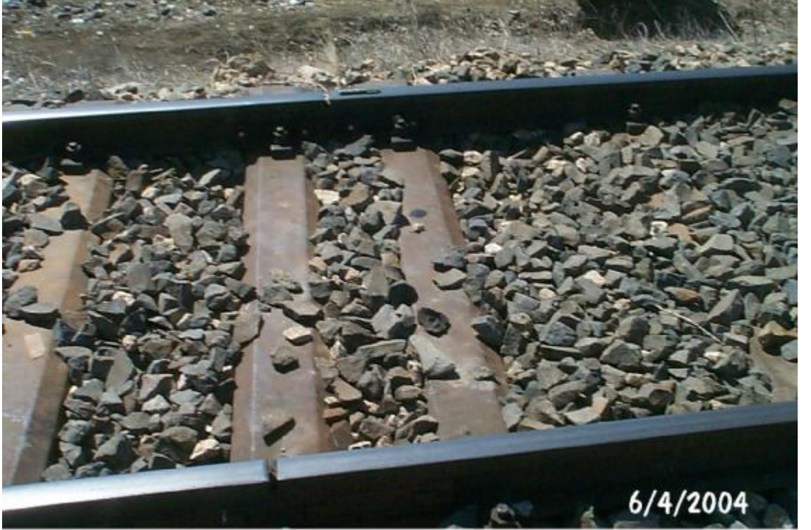
Foto 17: Küçükgeçit Köyü'nde demiryolu üzerinde depremle meydana gelmiş zemin deformasyonları. Bakış doğuyadır.
