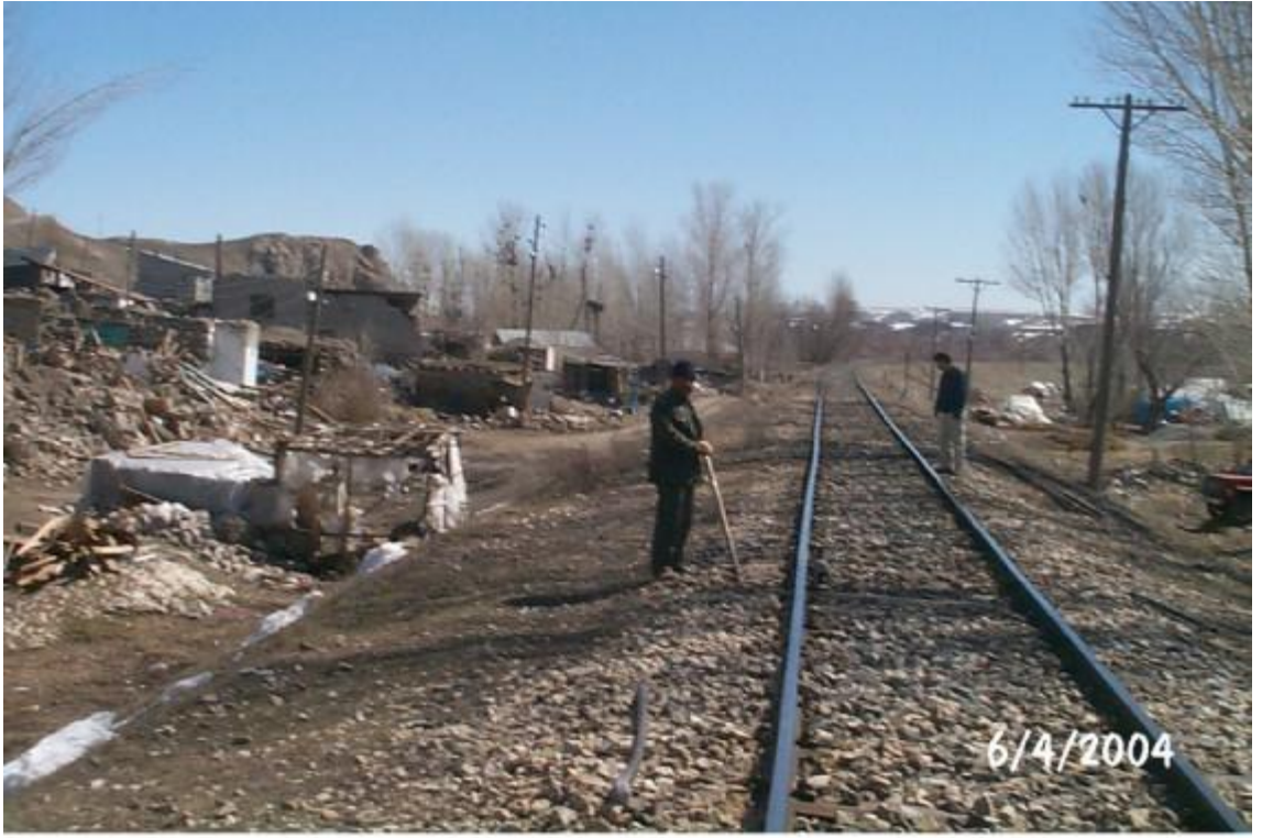
Foto 16: Küçükgeçit Köyü'nde demiryolu üzerinde depremle meydana gelmiş zemin deformasyonları. Bakış doğuyadır.
