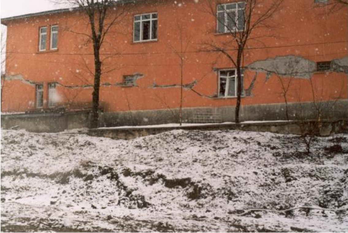
Foto 28: Kandilli Lisesi'nin kuzey tarafında depremde meydana gelen hasar ve çatlaklar.
